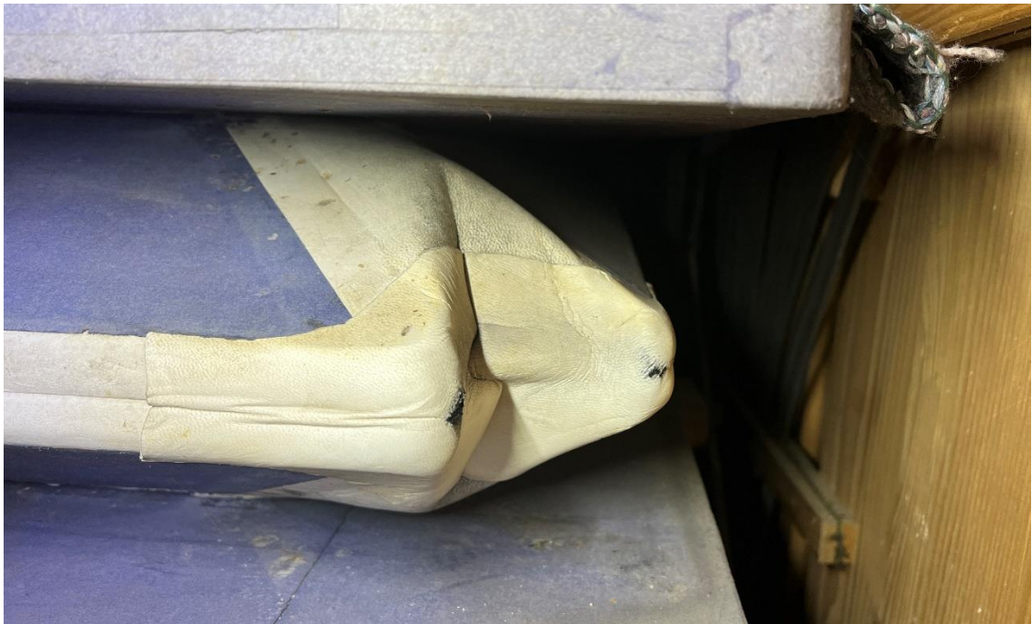
Abbildung 46 Undichtigkeiten in den Balgzwickeln
