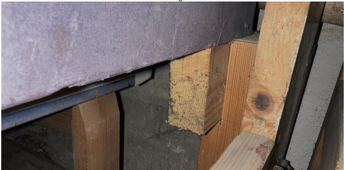
Abbildung 52 Abgesägtes Tragwerk der Balganlage
